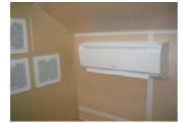
(a) 家庭用エアコン
